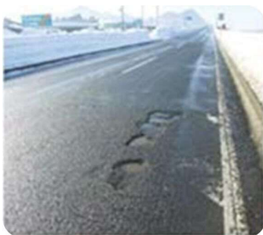
路面の穴ぼこ・ 段差
