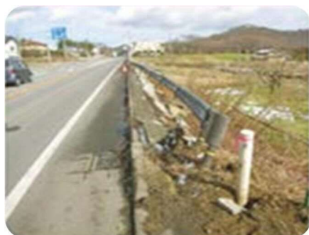
ガードレール・ 標識等の損傷
