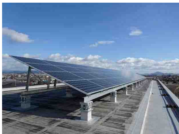
弾正小学校の太陽光パネル設置状況
