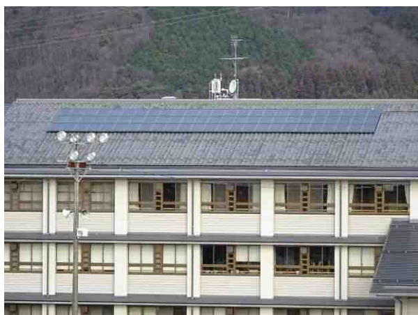
本巢中学校の太陽光パネル設置状況
