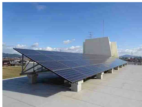
土貴野（ときの）小学校の太陽光パネル設置状況
