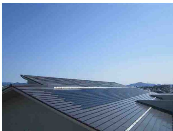
真桑小学校の太陽光パネル設置状況
