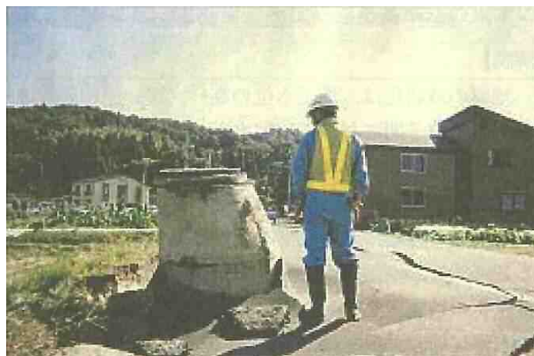
図 2-3 マンホールの浮上（新潟県中越地震）
