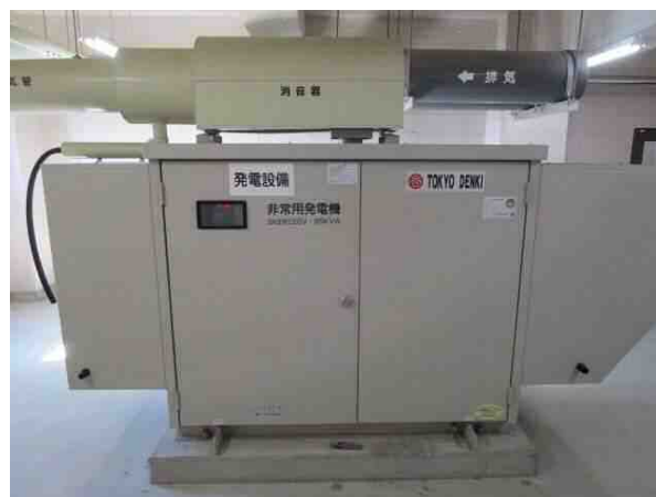
図 2-4 自家発電設備（非常用発電機）
